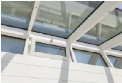
/ Das Oberlicht wurde mit speziellen Winkeln unsichtbar auf der Innenseite der Balkonplatte befestigt.
